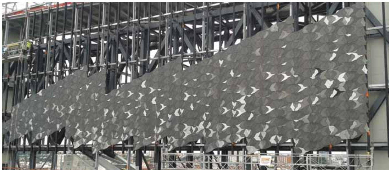
Het gebouw van het Filharmonisch Orkest in aanbouw, La Viletta, Frankrijk. (Foto: Aldor bv)
