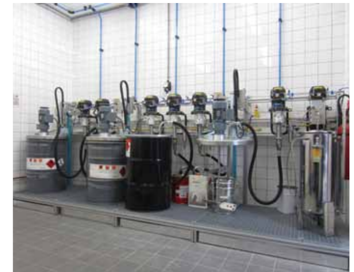
De Wagner pompinstallatie gekoppeld aan de Wagner digitale doseer- en menginstallatie. (Foto: WSB Wagner)
