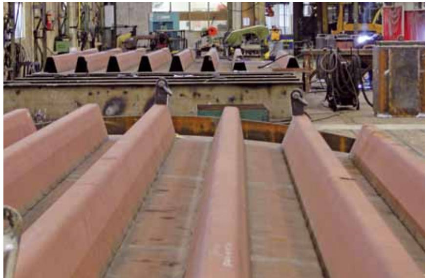
Fabricage van de brugdelen. De lange lussen worden geautomatiseerd aangebracht met een in eigen huis ontwikkeld systeem.
