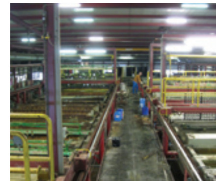
De badenreeks in Coevorden kan in drieploegenbedrijf een gigantische doorzet realisatie, maar is ook inzetbaar voor kleinschalig werk. (Foto: CPC Coevorden)
