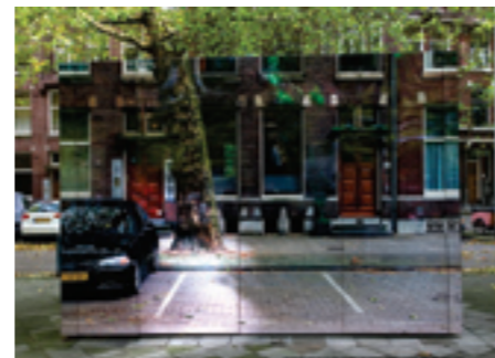
Een levensecht gedecalliseerd transformatorhuisje in Rotterdam. Uiteraard is met deze foto ook weer een presentatiepaneel gedecalliseerd. (Fotografie: Roeland Otten)
