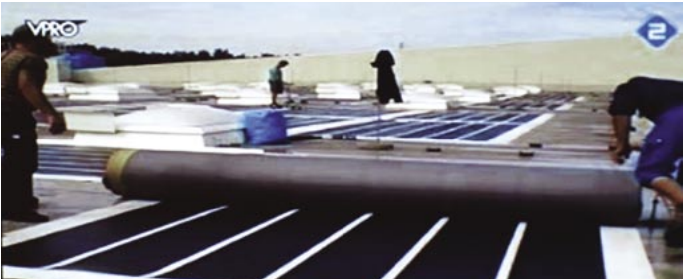
Zelden werd de oppervlaktetechniek zó getraceerd op televisieaandacht als in oktober: VPRO's Tegenlicht bracht zonnecollectoren, zonnefolie (foto) en zonnekrachtspiegels in twee afleveringen van de serie over duurzame energie; National Geographic Channel bracht ook de zonnekrachtcentrales (zie voorpagina van september), daarnaast was de conservering van de deltawerken met zonnerelectiecoating (vanwege het verschil in uitzettingscoëfficiënt van staal en coating) op Discovery Science.
