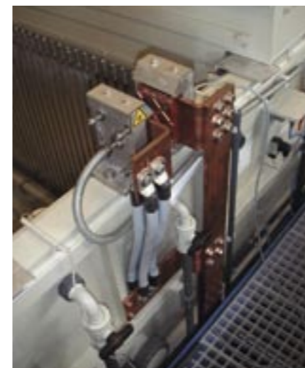
Pulscoat®: anodische stroomaansluiting.
